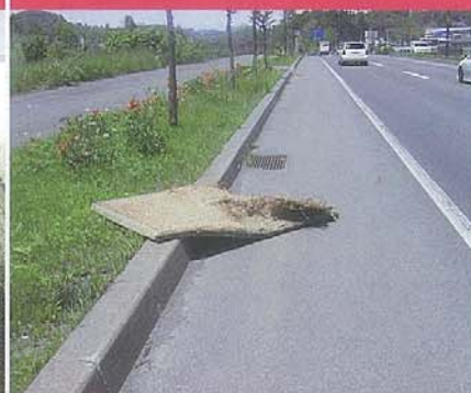
路面の落下物
