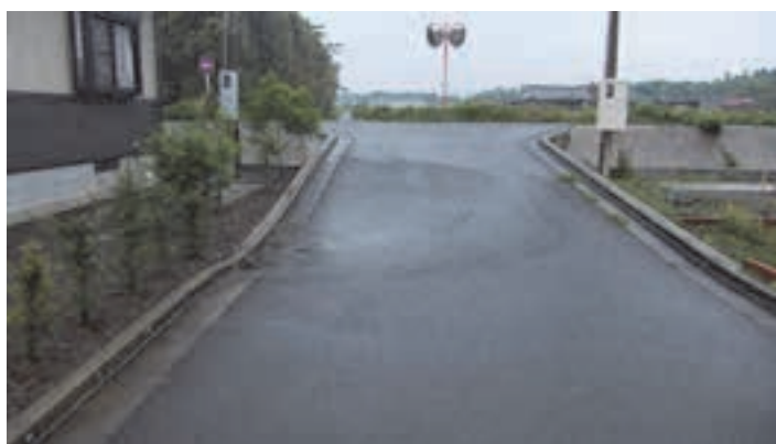
道路の凹み【平成22年4月】
