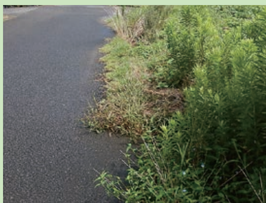
※側溝からの雑草等繁茂状況
