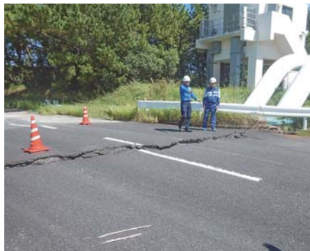
基地内道路に亀裂
