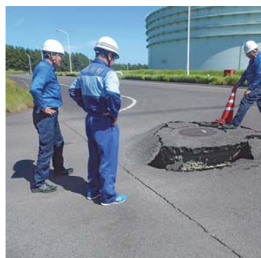
基地内液状化の状況
