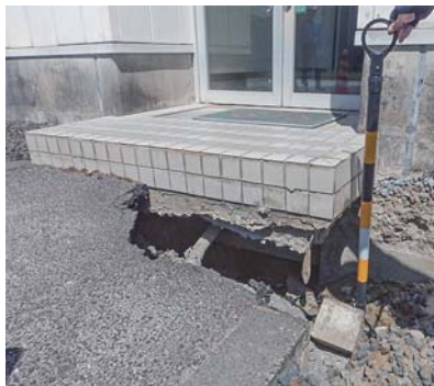
基地内施設の液状化による地盤陥没
