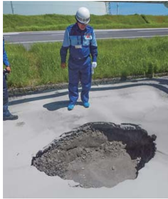
町長も被災状況確認【基地内液状化の状況】
