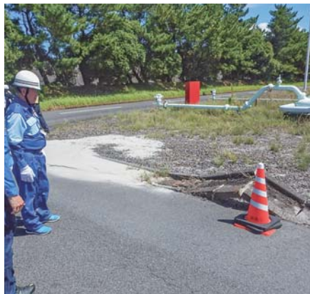
基地内道路に亀裂
