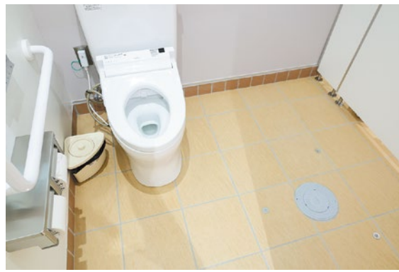
マンホールトイレ平常時
