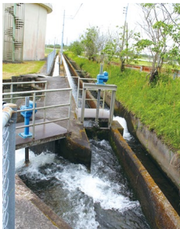
水流を活用した発電はできないか(三面水路と揚水機場)
