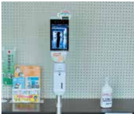
公共施設にサーマルカメラ 10台を設置 67万円
