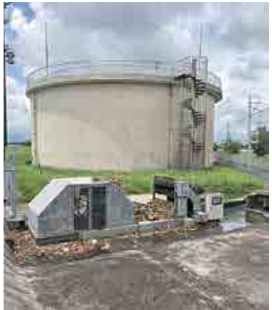
(▲水田への送水をするパイプライン施設) 電気料金高騰の影響を受けている
