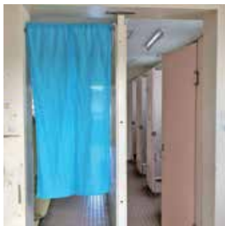
男女トイレが同一空間に設けられている構造
