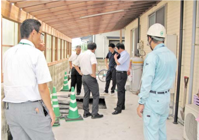
コンクリートを裁断し陥没の状況を確認
