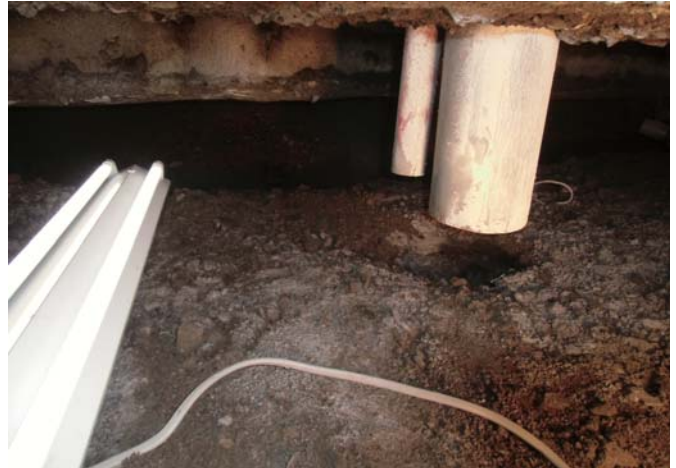
ベタ基礎の下が陥没。浄化槽への配管が外れている
