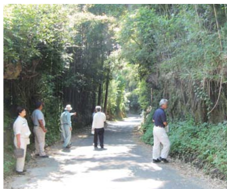
道路脇の土手崩れが心配(境地区)
