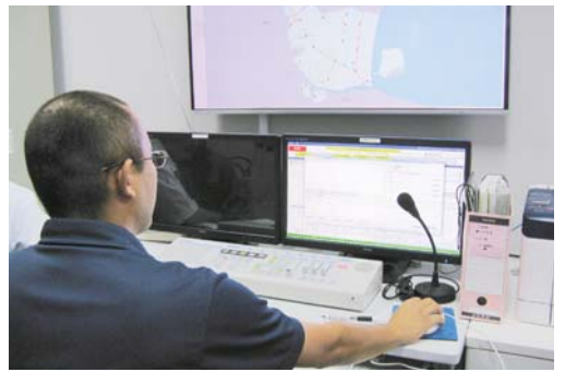
平成元年導入の防災無線設備を更新
