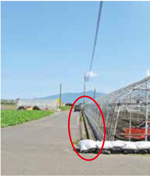
▲コバックを始点とする排水路 個人で排水路を造っており、少しの雨で溢れる。ブロックを積みかさ上げが必要
