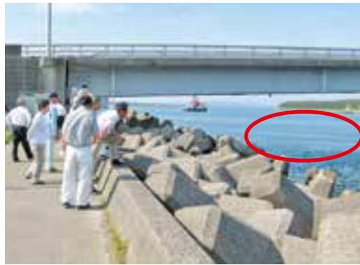
▲備蓄基地への橋の下 土砂が滞留し、漁船の航行に支障がある調査時は満潮で確認できず（赤の囲み部分）
