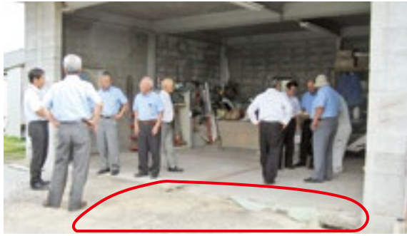
赤囲みは土地が陥没（にぎやかタウン雪山）
