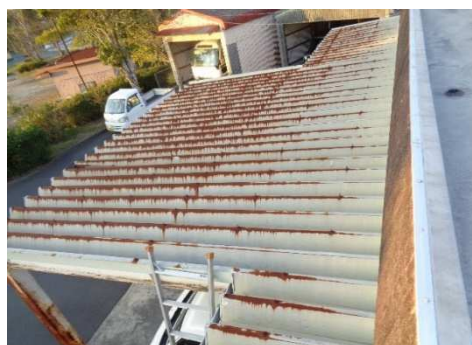
④北西側庇屋根:発錆
