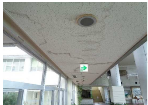
⑩1階ホール天井:染み跡
