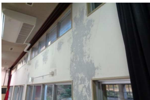
⑪集会室:塗装の剥がれ
