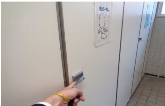
⑦女子トイレ:ドアの開閉不良
