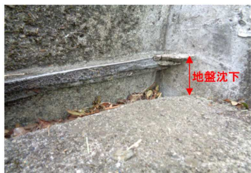
⑥北西側建物廻り:地盤沈下
