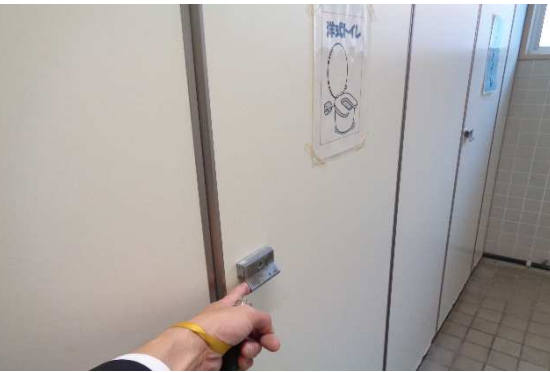
⑦女子トイレ：ドアの開閉不良
