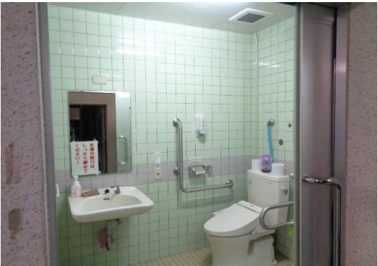
⑥身体障がい者用トイレ：換気性能の低下 (臭気あり)
