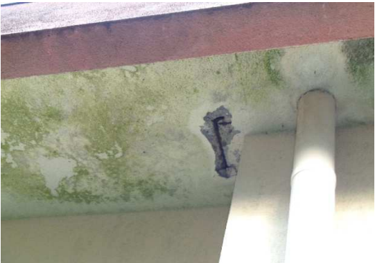
⑧南西側軒裏：爆裂・塗装の剥がれ
