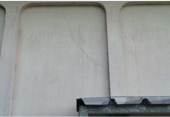
③東側外壁：クラック
