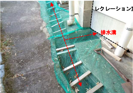
⑩南側建物廻り：排水溝のつまり対策・過去に陥没あり
