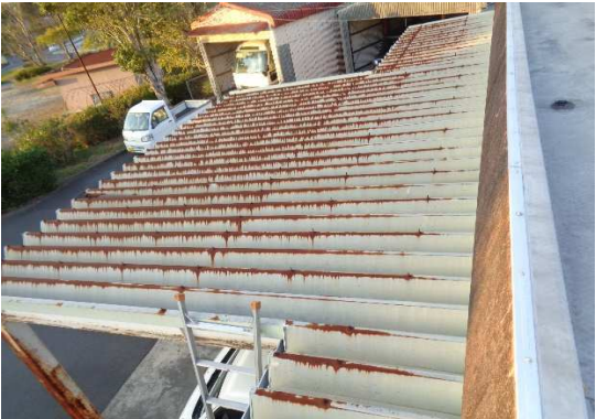
④北西側庇屋根：発錆
