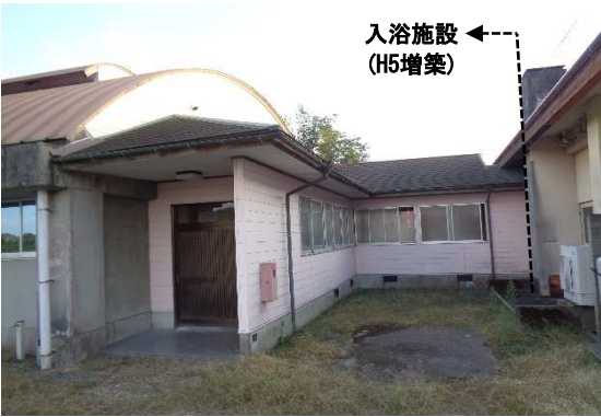
②入浴施設 (H5増築)：未修繕箇所多数
