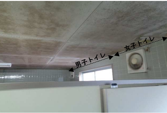
⑤男女トイレ：男女のトイレ間に間仕切壁なし (音漏れ)
