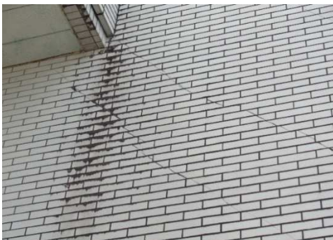
⑪南東側外壁タイル:クラック
