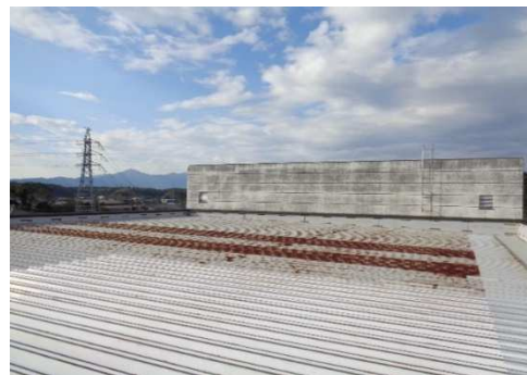
④大ホール上部屋根:発錆
