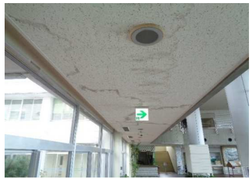
⑩1階ホール天井:染み跡
