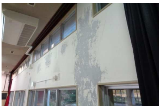
⑪集会室:塗装の剥がれ
