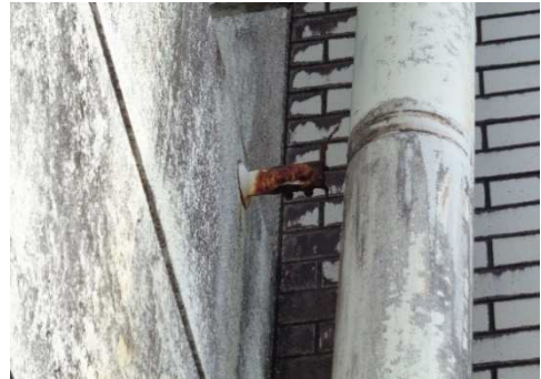
⑧西側縦樋支持金物:破損
