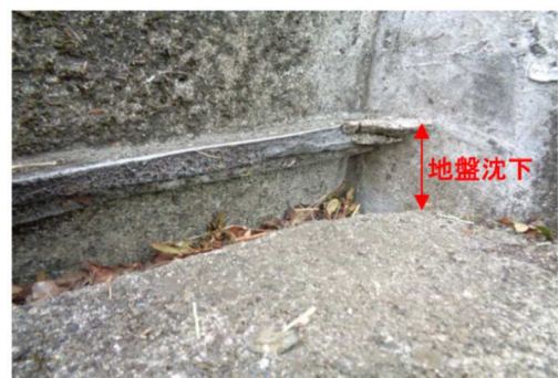
⑥北西側建物廻り:地盤沈下
