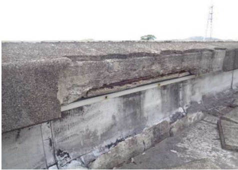
⑦南東側屋上パラペット:爆裂
