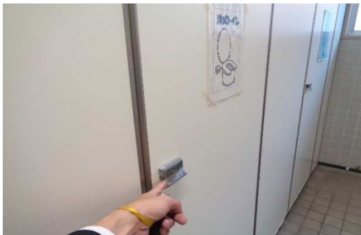
⑦女子トイレ:ドアの開閉不良
