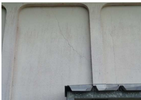
③東側外壁:クラック
