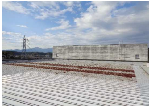
④大ホール上部屋根:発錆
