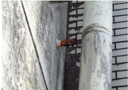
⑧西側縦樋支持金物:破損
