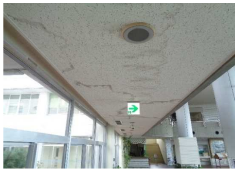
⑩1階ホール天井:染み跡
