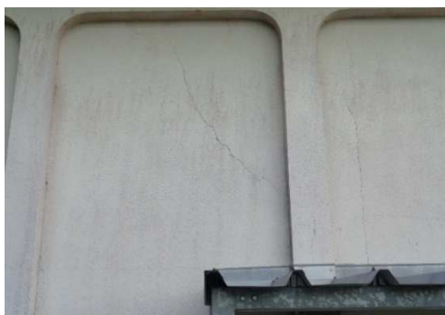
③東側外壁:クラック
