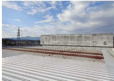
④大ホール上部屋根:発錆
