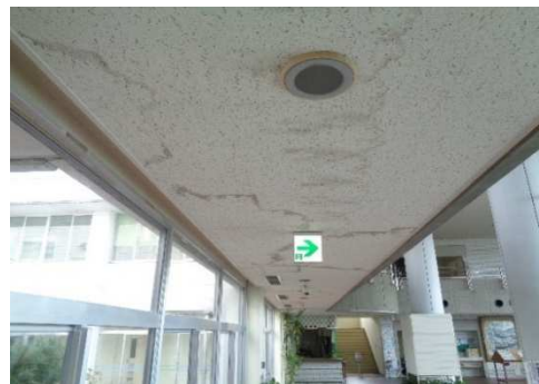
⑩1階ホール天井:染み跡
