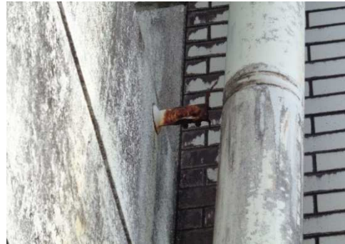
⑧西側縦樋支持金物:破損
