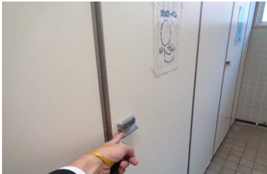
⑦女子トイレ:ドアの開閉不良
