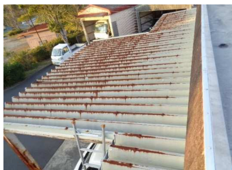
④北西側庇屋根:発錆
