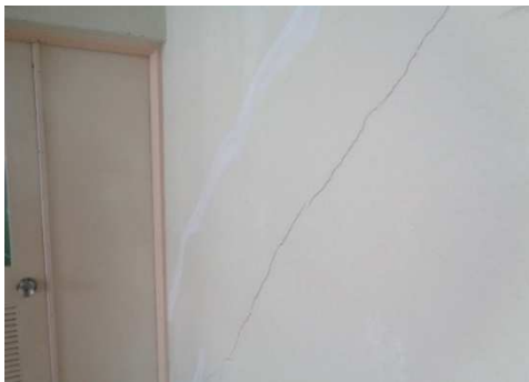
③2階南西側廊下壁:クラック
