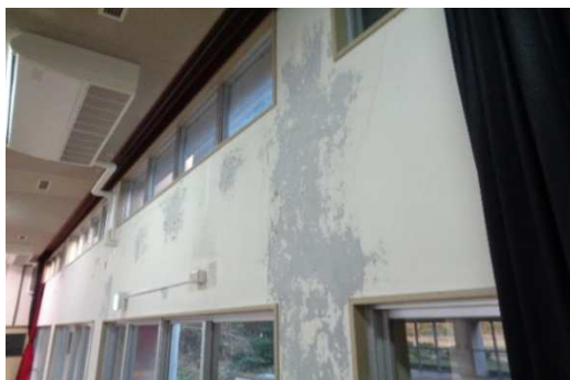
⑪集会室:塗装の剥がれ
