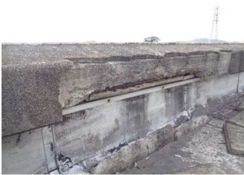
⑦南東側屋上パラペット:爆裂
