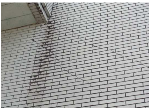
⑪南東側外壁タイル:クラック
