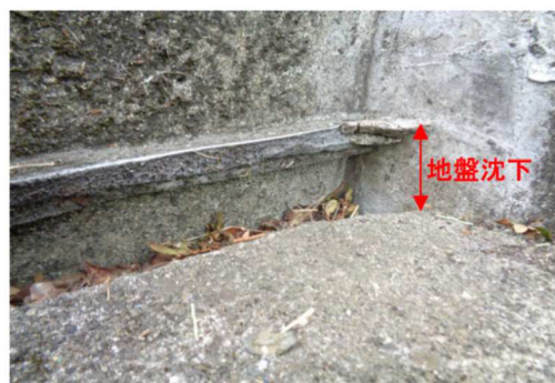
⑥北西側建物廻り:地盤沈下
