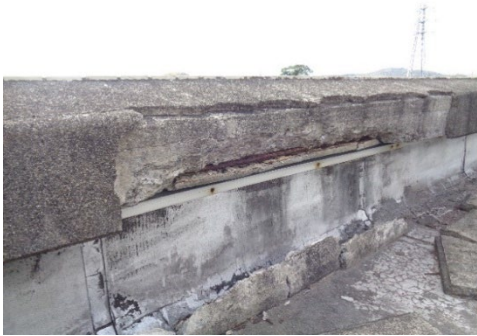
⑦南東側屋上パラペット:爆裂
