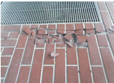
⑨エントランス廻り:床タイル剥がれ
