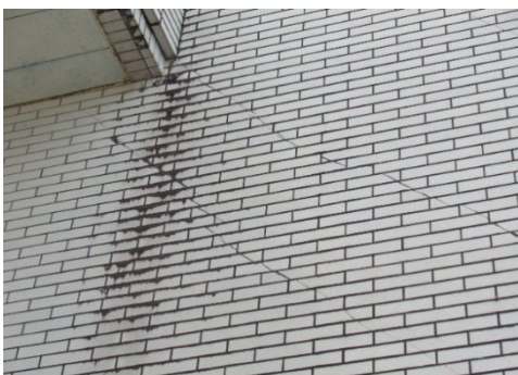
⑪南東側外壁タイル:クラック
