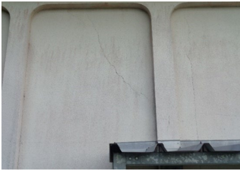
③東側外壁:クラック
