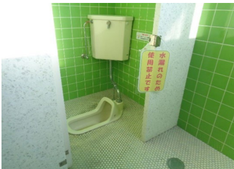
⑤2階男子トイレ:大便器水漏れのため使用禁止
