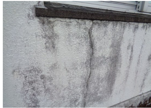
②南西側外壁:クラック・塗装の劣化・シーリング劣化
