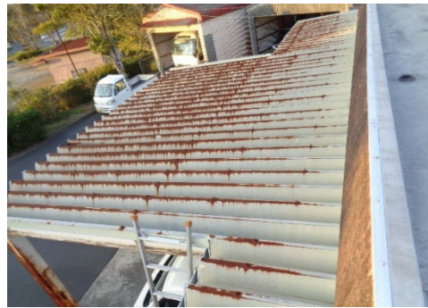
④北西側庇屋根:発錆
