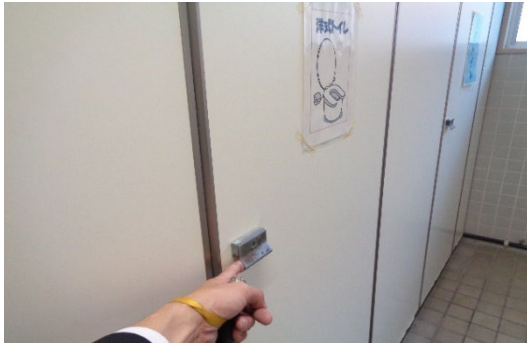
⑦女子トイレ:ドアの開閉不良
