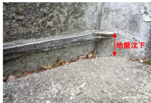
⑥北西側建物廻り:地盤沈下
