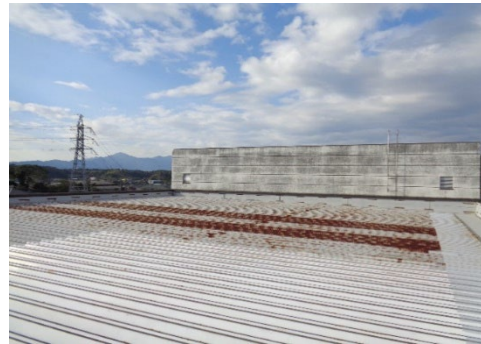
④大ホール上部屋根:発錆
