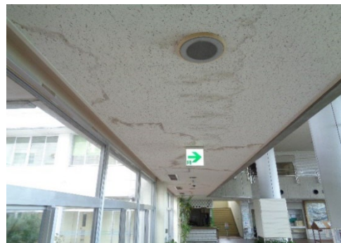
⑩1階ホール天井:染み跡
