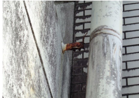
⑧西側縦樋支持金物:破損
