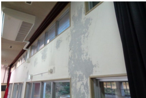
⑪集会室:塗装の剥がれ
