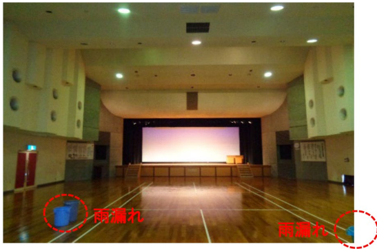
①1階大ホール:雨漏れ(バケツにて応急対応)
