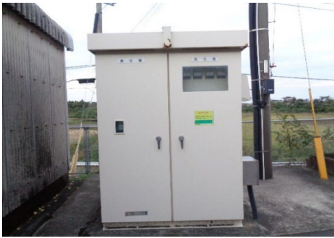
①北側キュービクル:更新時期を経過
